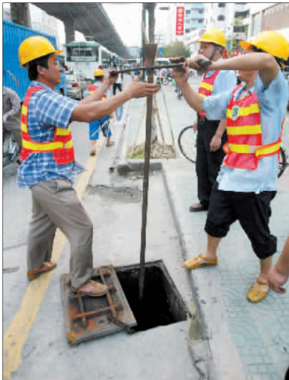
抢修人员在紧急关水闸。到昨日下午5时多,水流终于被控制住。
