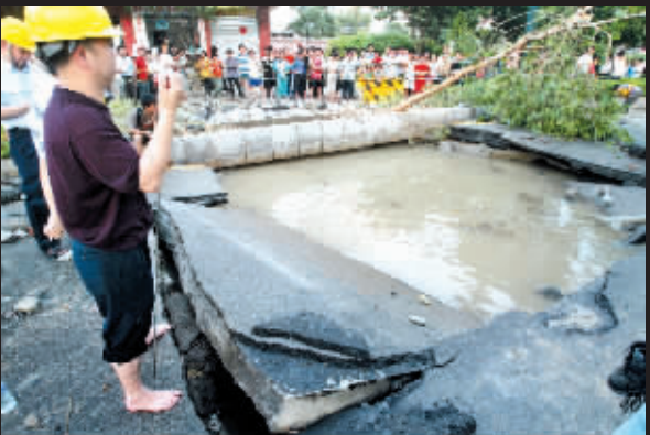
水管爆裂处留下一个大坑,引来不少过路行人驻足围观。
