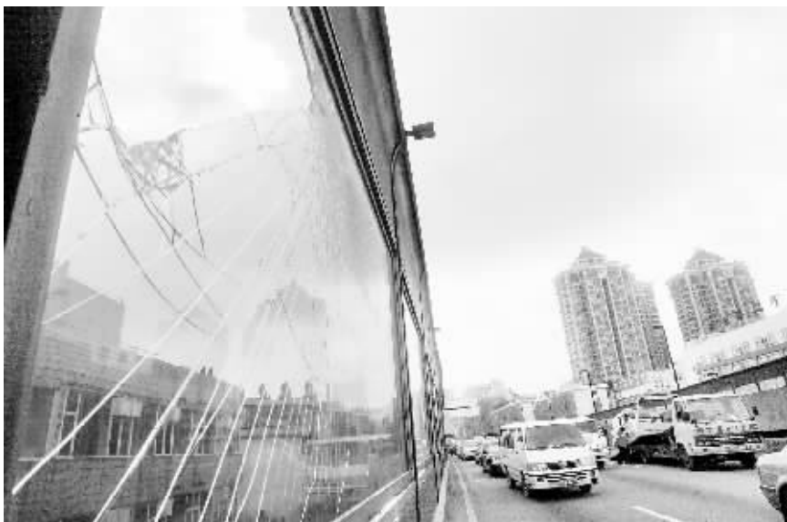
肇事车辆把内环路上的隔音墙撞出大洞。时报记者 郭柯堂 摄
