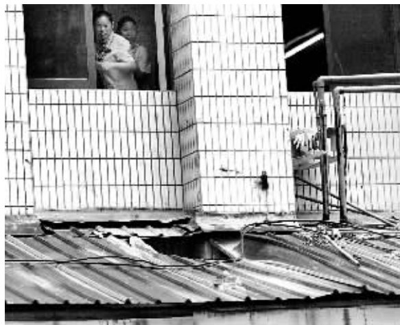
3楼篷架铁皮被坠下男子砸出一个洞。时报记者 朱元斌 摄
