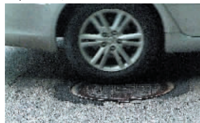
白云大道一处路面,井环提升后迟迟没有填平宽阔的坑缝
