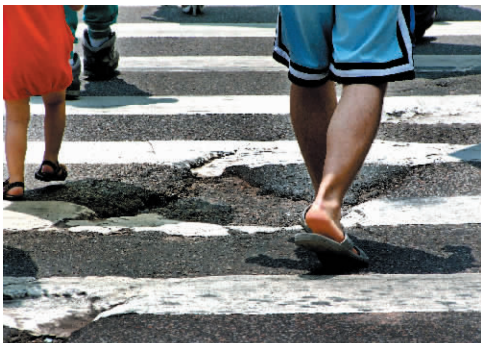
机场路一处人行横道烂路令行人深一脚浅一脚
