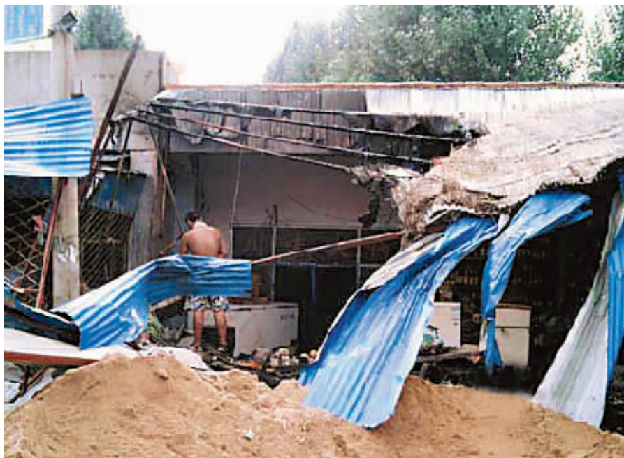
图为交通事故中撞坏的路边店铺。中新
