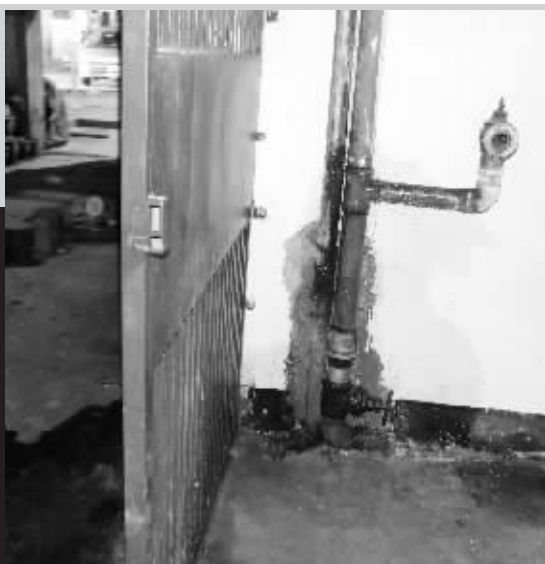
公共区域维修动用维修资金程序繁琐，致其使用渠道不畅支配使用困难。 时报记者 黄亦民 摄
