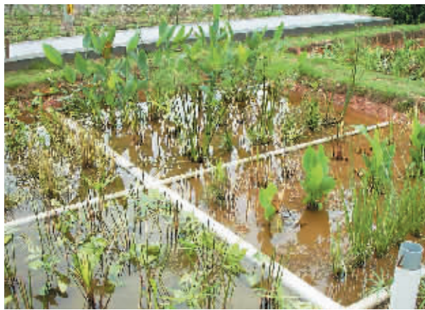
“神奇湿地”里,植物下面是1米深的沙、20厘米厚的砂砾,还铺有管道。
