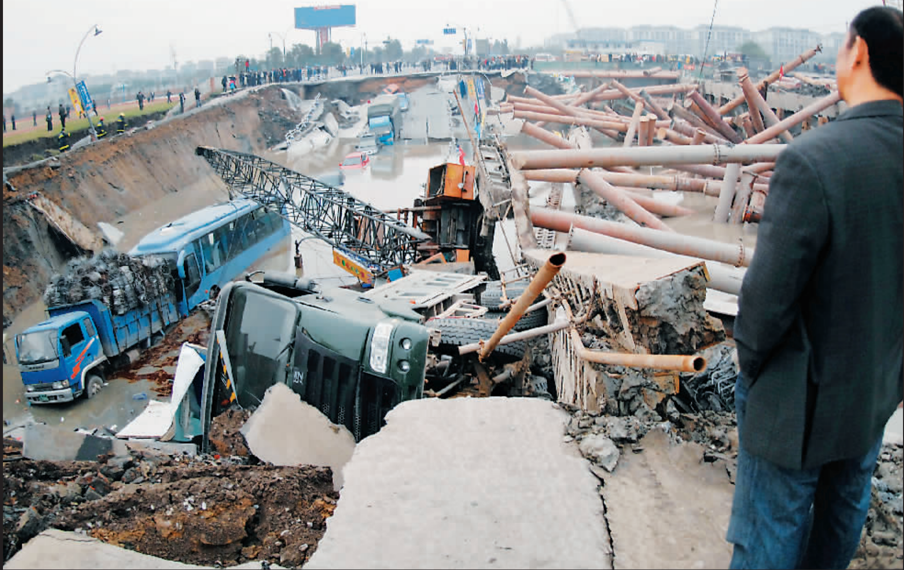
昨日 15 时许，杭州风情大道地铁施工工地发生大面积地面塌陷事故，十多辆行进中的汽车坠入塌陷处。CFP 供图
